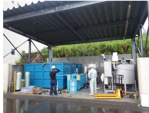
排水処理施設
