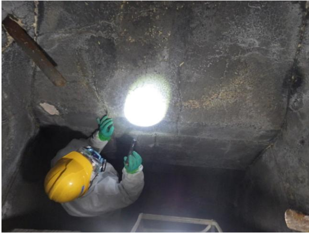
ガス化炉除染後
